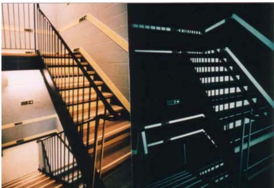
Figure 5 – Cage d'escalier avec éclairage normal et avec éclairage photoluminescent sans plus
